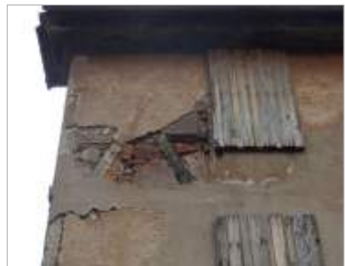
Schäden an der Fassade der Wiesenmühle
